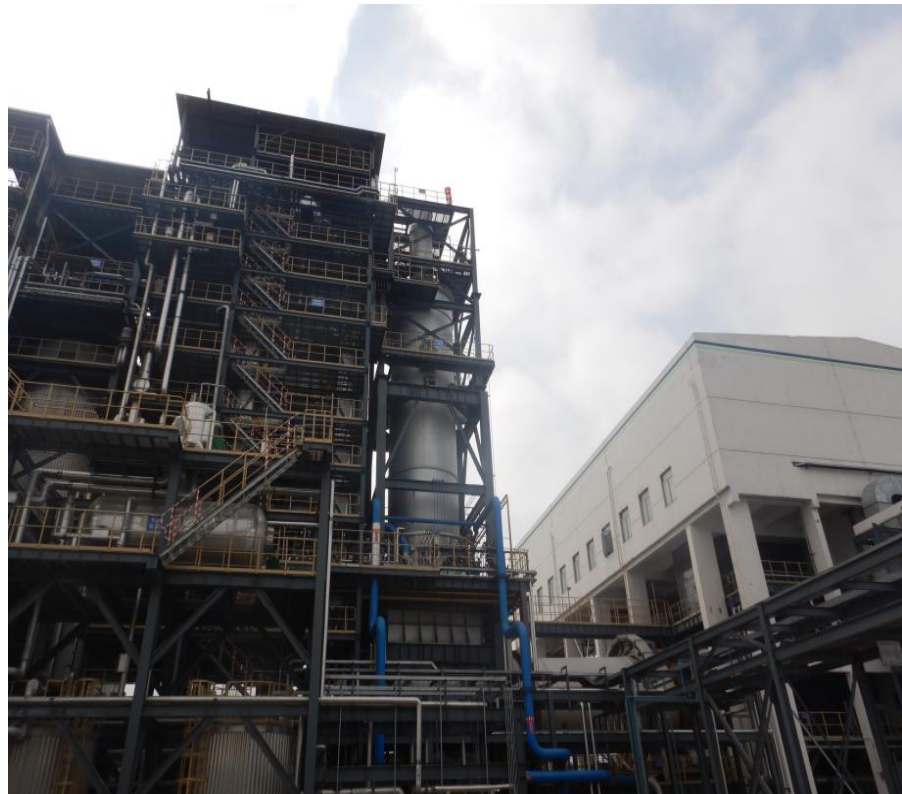
焚烧炉二燃 室
